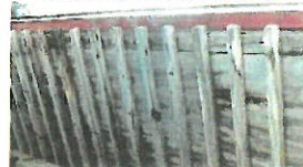
屋根裏側の腐食と雨漏り
